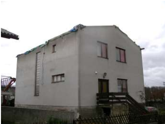
Das durch den Orkan "Kyrill" abgedeckte Wohnhaus in der Sandweg-Siedlung 2007.
